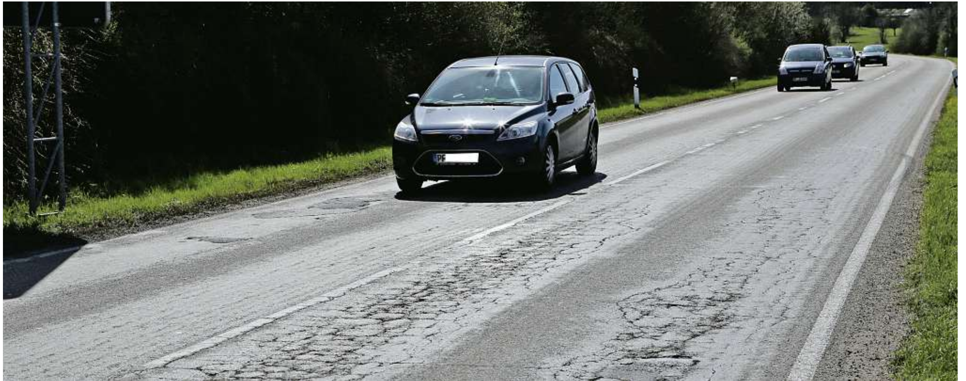
Auf der Landesstraße 565 zwischen Birkenfeld und Neuenbürg sind Risse und Schlaglöcher die Folgen von Minusgraden und Frost.
